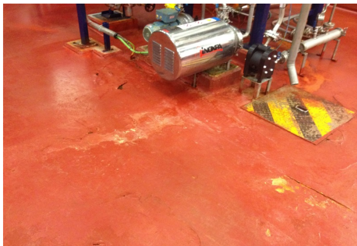
Estado inicial de las instalaciones por ataque químico con temperatura
